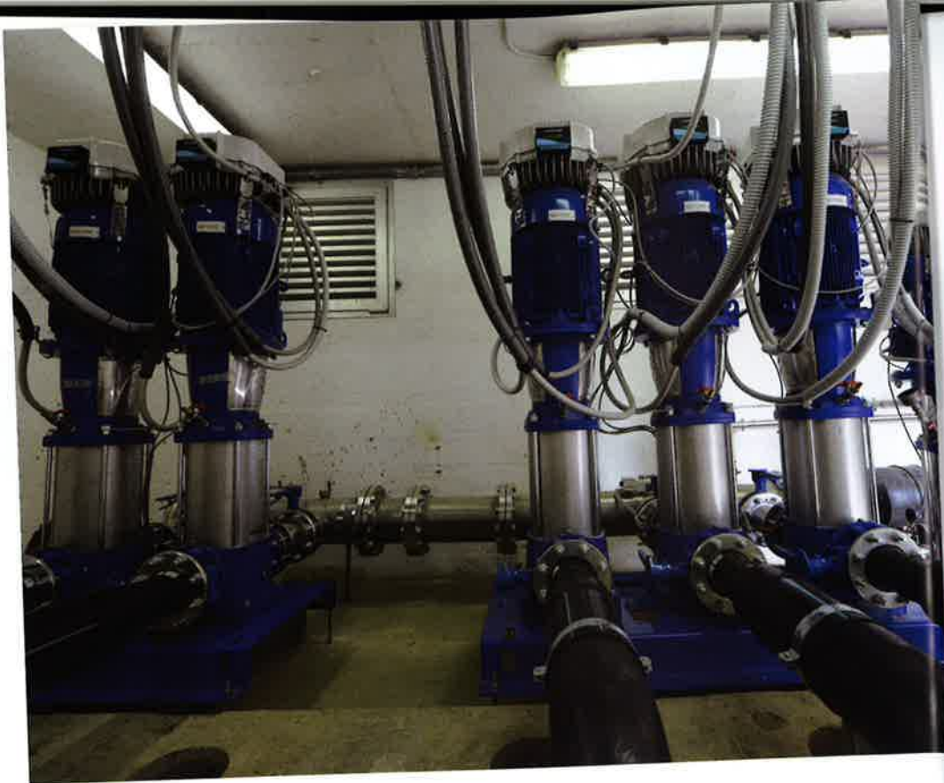
Il nuovo gruppo di pompaggio composto da sei elettropompe multistadio verticali della serie e-SV. Quattro elettropompe sono di servizio, una di riserva e una pilota per le piccole esigenze idriche e per l'approvvigionamento invernale
